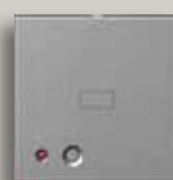
Relais pour alarme technique
