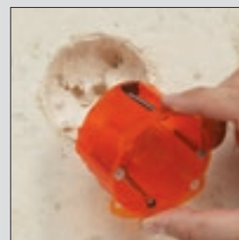
Pénétration limitée des matériaux de scellement
